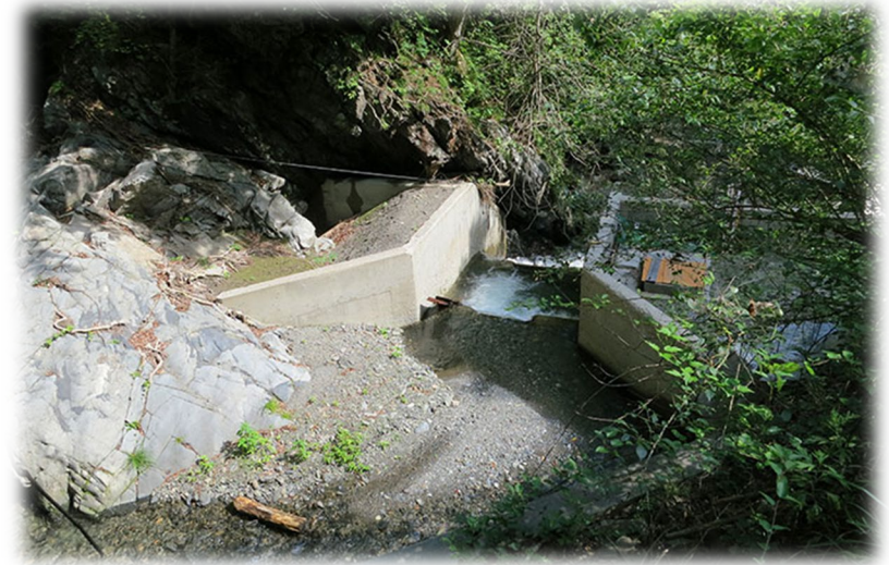
土砂崩れ等で損壊した取水施設
