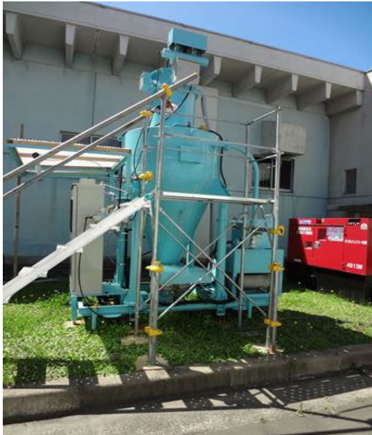
仮設の粉末活性炭注入設備
