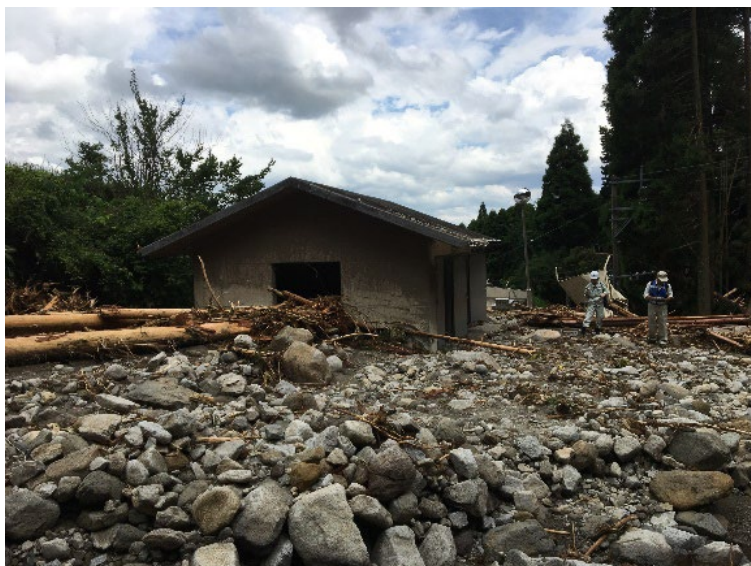
▲被災した竹浄水場 (東峰村役場 提供)
