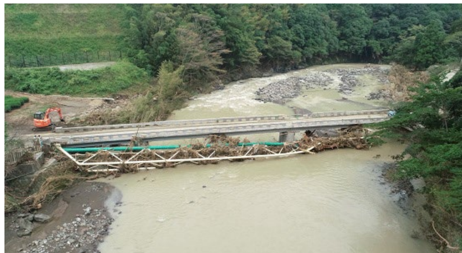
令和4年台風第15号によって発生した流木によって崩落した水管橋（静岡市HP、2022年9月）
