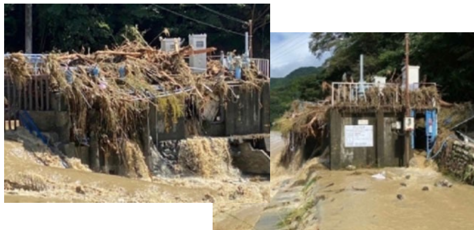
令和4年台風第15号によって発生した流木と土砂により閉塞した取水口（静岡市HP、2022年9月）
