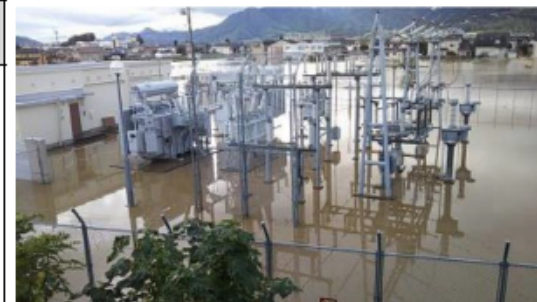
令和元年東日本台風で水没した変電所
