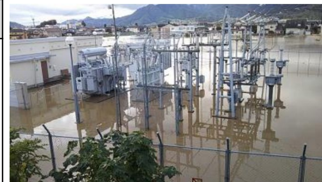
令和元年東日本台風で水没した変電所
