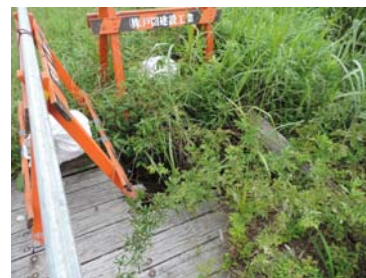
老朽化して腐食した橋
