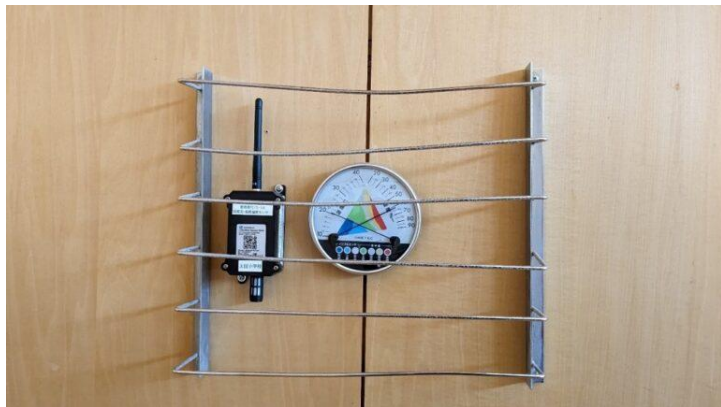
学校体育館に設置されたセンサー
